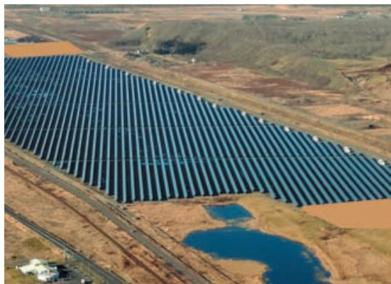
白糠太陽光発電所全景写真
