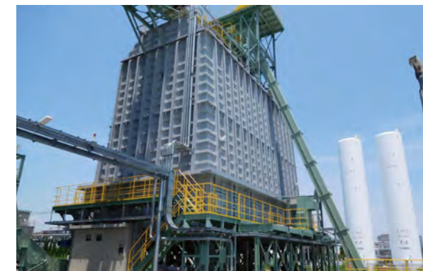
クラボウ徳島 バイオマス発電所 燃料受入・供給設備
