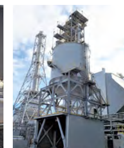
相馬エネルギーパーク(同) 相馬石炭・バイオマス発電所 灰処理設備
