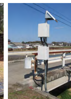
水位計測設備
