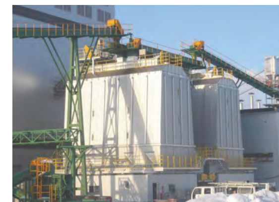
津別単板協同組合 燃料供給設備
