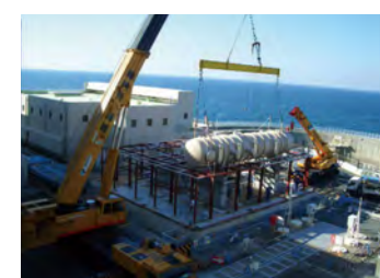
海水淡水化装置設置
