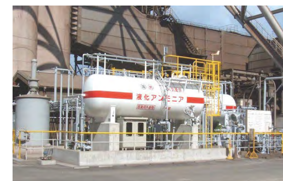
戸畑共同火力(株) アンモニア供給設備
