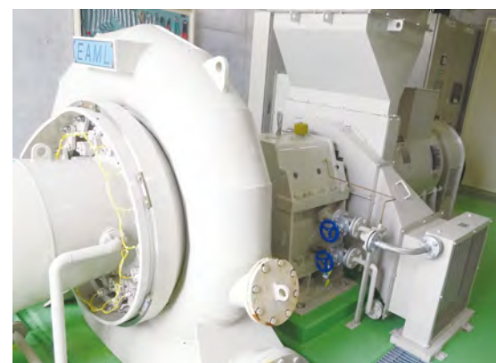
愛媛県 畑寺発電所 水力発電設備
