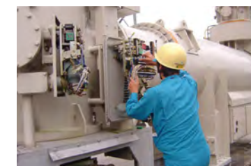
変電所設備 定期検査
