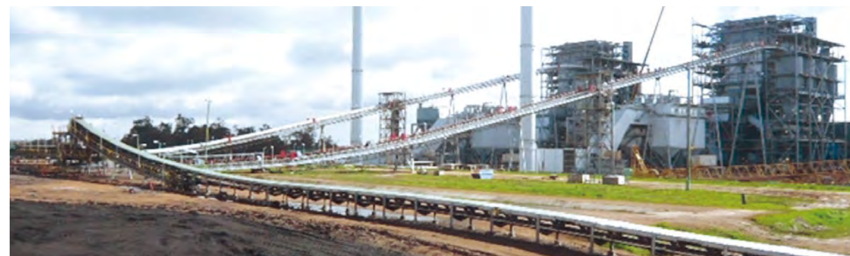
オーストラリア Bluewaters 発電所 運炭設備
