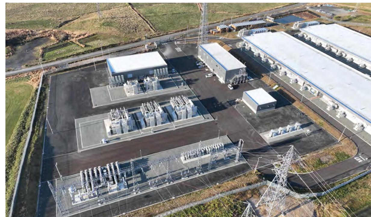
北部風力送電 受変電設備
