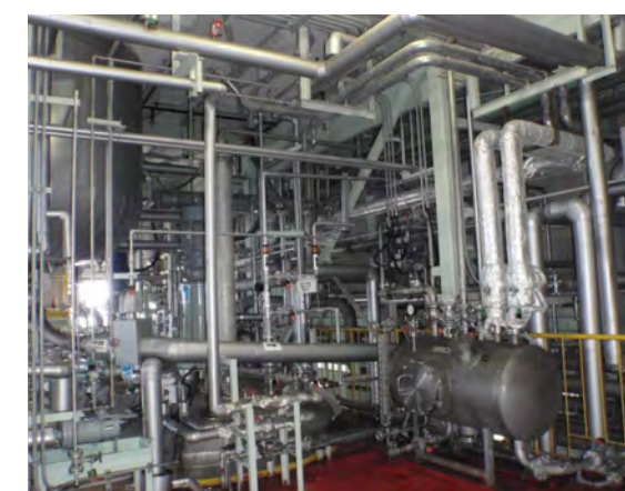
日立化成ポリマー(株)阿南工場 4号反応釜設備
