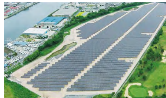
詫間太陽光発電設備 (メガソーラー)
