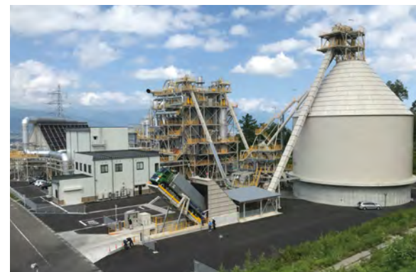
ソナノウッドパワー発電所 バイオマス燃料受入・供給設備
